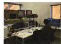
中央制御室 ボイラー及びタービン発電機その他諸機器を監視制御します。
