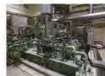
蒸気タービン発電機 ボイラーから発生した蒸気を利用して発電を行います。
