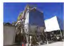
バグフィルタ 排ガスの塵埃などを除去し、クリーンな排ガスにします。
